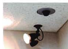
体育館更衣室入口の防犯カメラ
