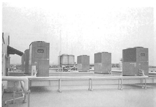
屋上に設置された屋外機
